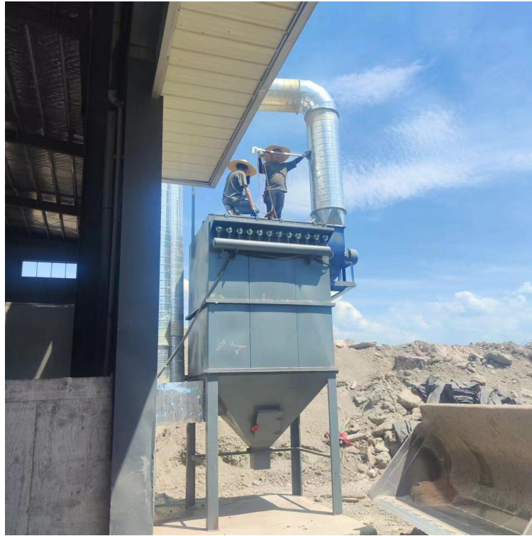
图 3-5 废气处理现场图
