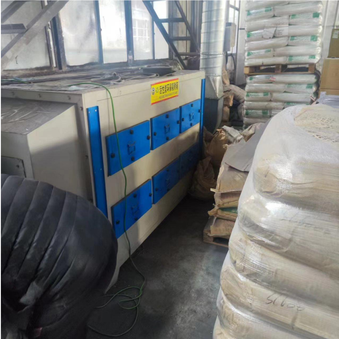
图 3-3 ③A 挤出废气处理现场图
