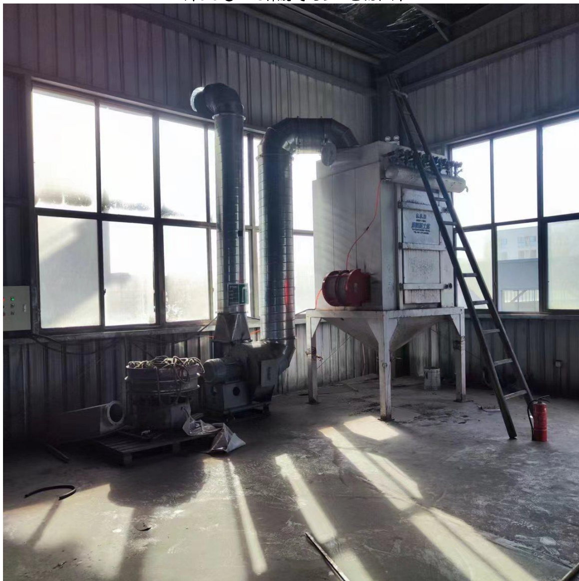
图 3-9 混料废气处理现场图
